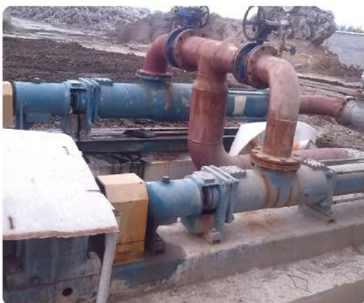
板框压滤机进料
