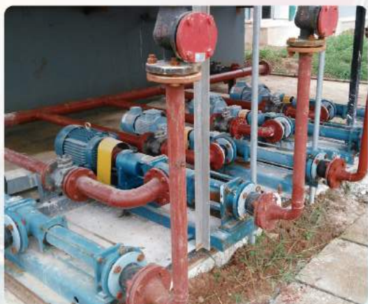
污水处理厂石灰浆计量
