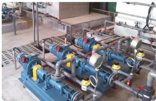
煤矿污水站PAM制备
