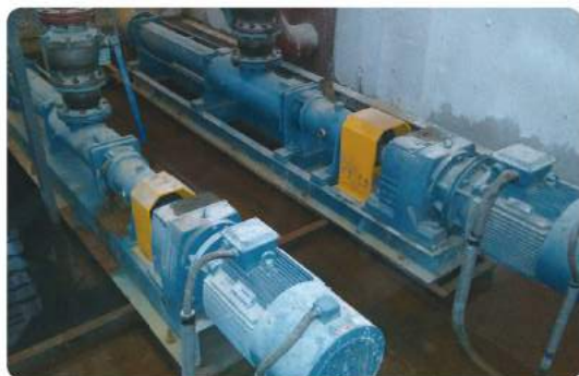
城市污水处理厂污水输送
