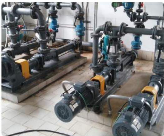
电厂污水输送
