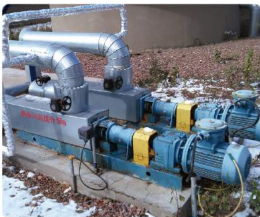
石化厂污水提升泵
